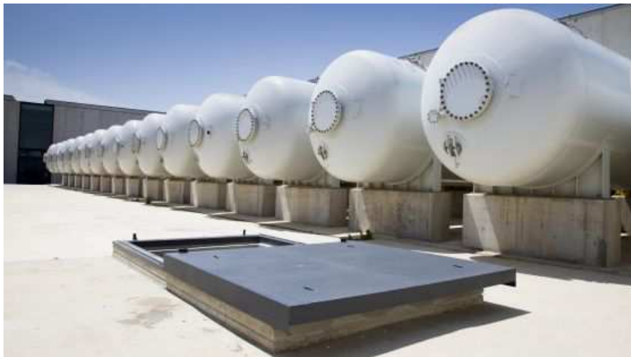
Instalaciones de la planta desaladora de Torrevieja. / PEPE OLIVARES
