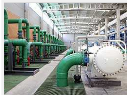
Instalaciones del interior de la desalinizadora de Carboneras en Almería.
