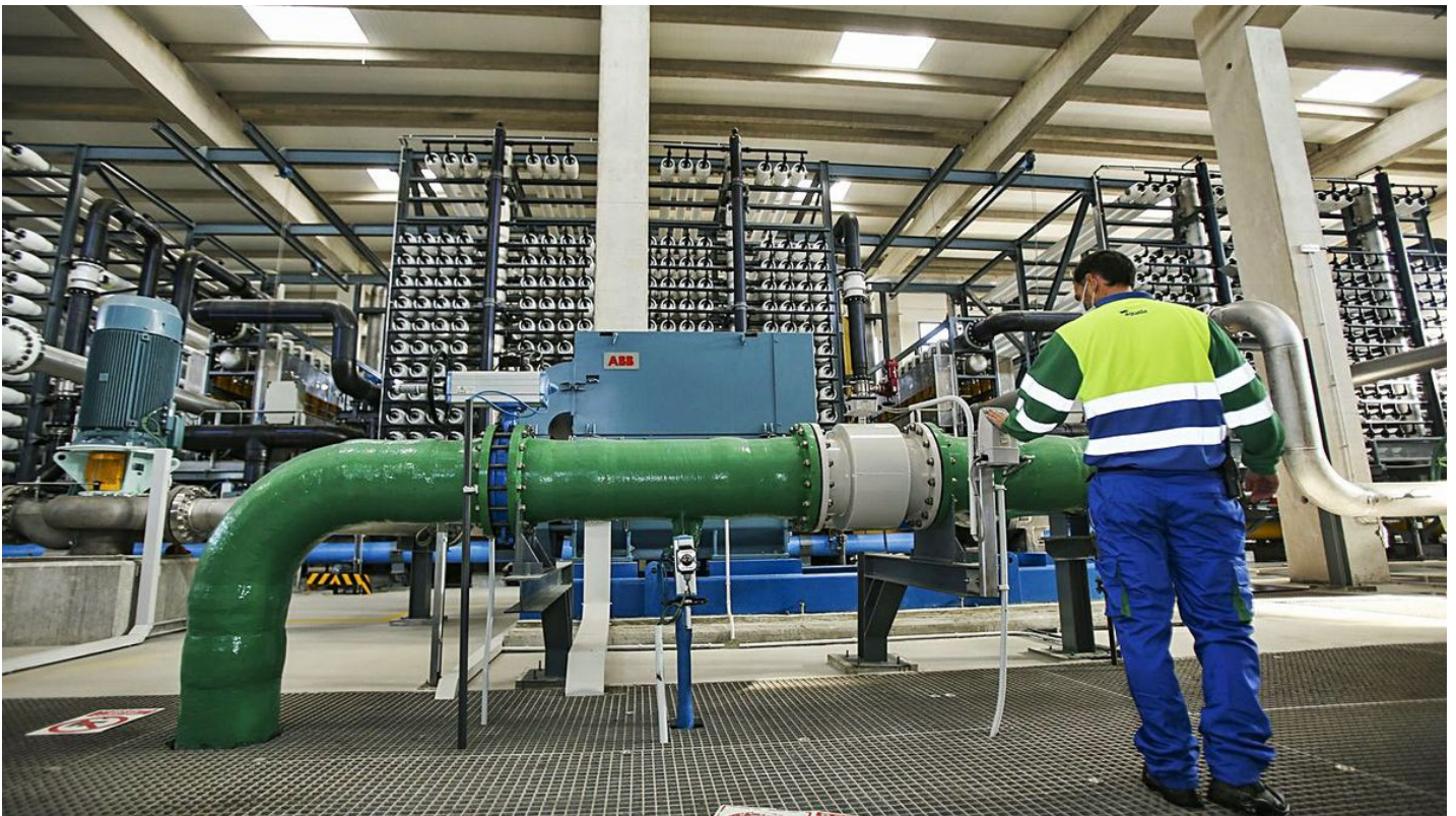
Un operario de la planta de Mutxamel revisa el estado de las instalaciones. | MANUEL R. SALA
