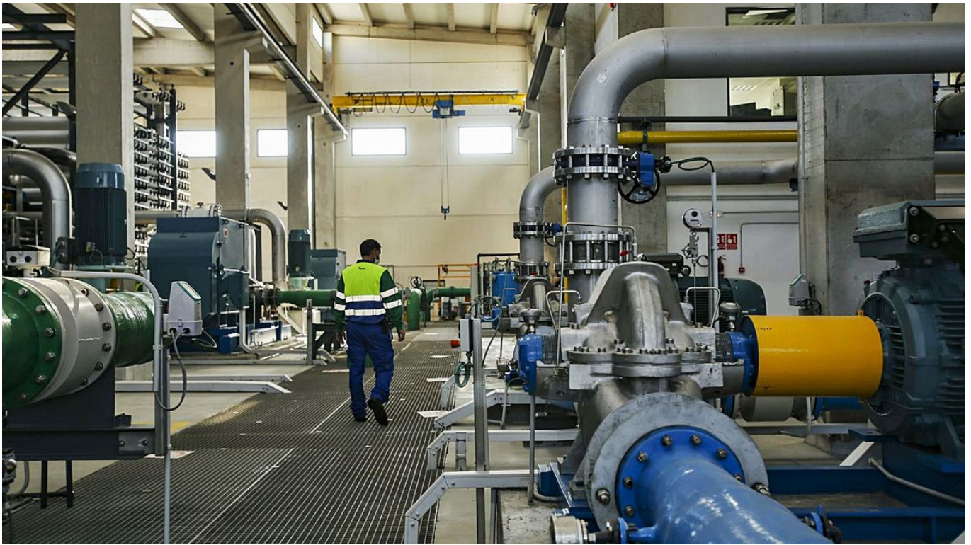
La planta tiene capacidad para desalar y depurar 18 hm 3 de agua del mar al año. | MANUEL R. SALA
