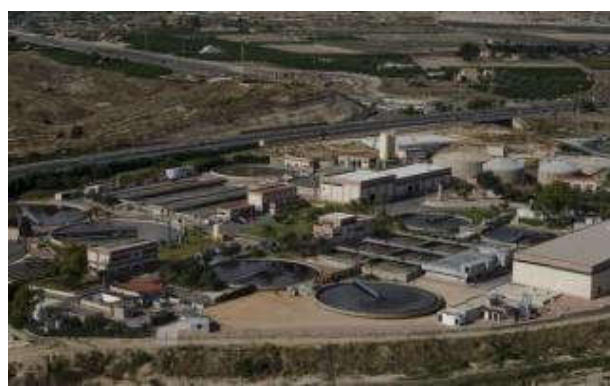
Vista aérea de la depuradora alicantina de Rincón de León «fábrica» de agua depurada pero que no se puede llevar a
