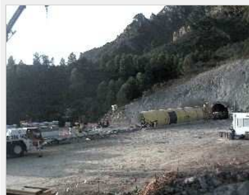
HORADAR LA SIERRA. Instalación de una tuneladora de gran volumen en el término municipal de Alzira, la pasada semana. / L. V.
