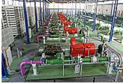
Instalaciones de la desaladora de Aguamarga en Alicante.
