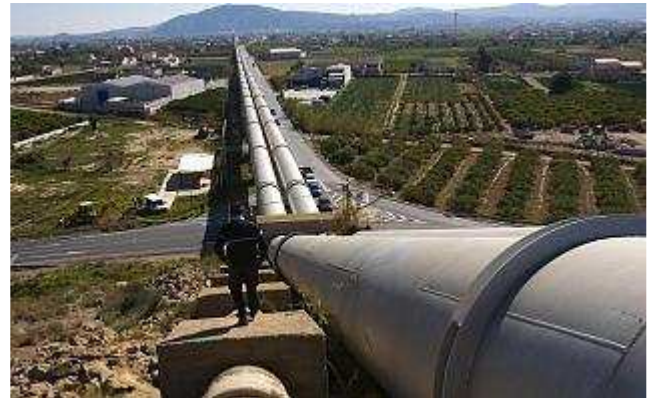
Imagen de la canalización del trasvase Tajo-Segura en Orihuela. Una infraestructura amenazada si prospera el Estatuto castellano-manchego iANTONIO AMORÓS
