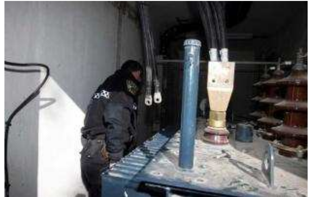
Uno de los transformadores de El Hondo asaltados. DIEGO FOTÓGRAFO:
