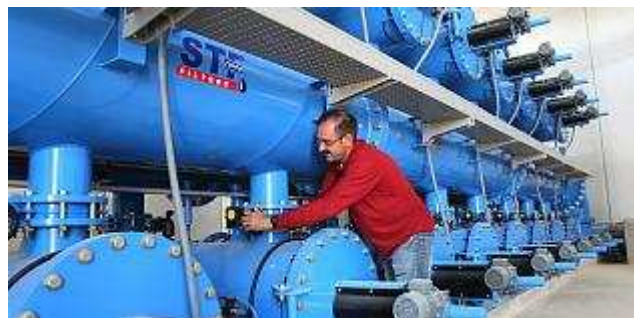
Un técnico de Riegos de Levante supervisa la infraestructura para el filtrado del agua, evitando así que el mejillón cebra llegue a los sistemas de riego por goteo en el Campo de Elche
