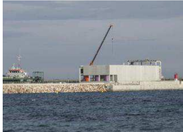
Imagen de la estación de bombeo en el puerto de Torre Vieja ya terminada. tony Sevilla
