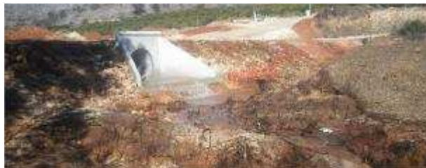
La fuerza del agua arrastró parte de la obra de una escollera hasta el barranco de Sendes Velles. e. car
