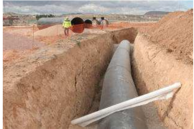
Técnicos de la Conselleria junto a la tubería para conectar el postrasvase con el Júcar-Vinalopó. CRUCES-CRUCES
