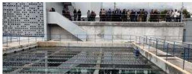
Las nuevas instalaciones de la planta de agua potable inauguradas ayer, aumentarán el caudal de tratamiento para tener asegurado el suministro. DAVID REVENG
