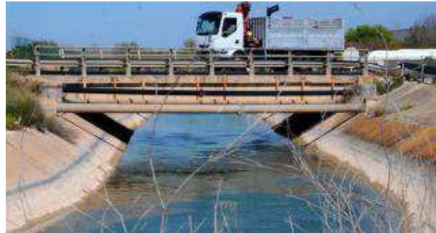
Un camión pasa por encima de uno de los canales auxiliares del Tajo-Segura por el que se reparte el agua del trasvase en la provincia. LOINO
