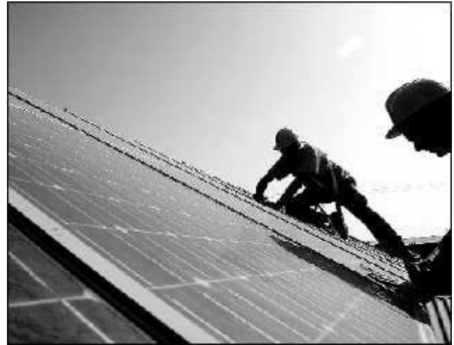
Instalación de paneles solares en una zona agrícola de la provincia
