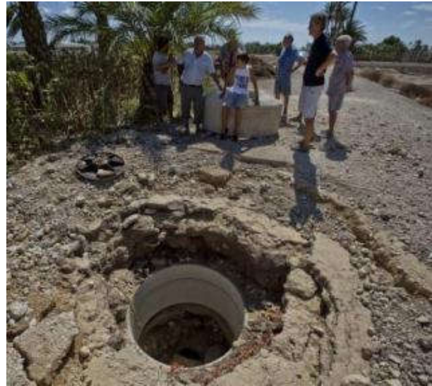
Uno de los canales averiados de Riegos de Levante que abastece agua a cerca de 8.000 agricultores y familias del Camp d'Elx.
