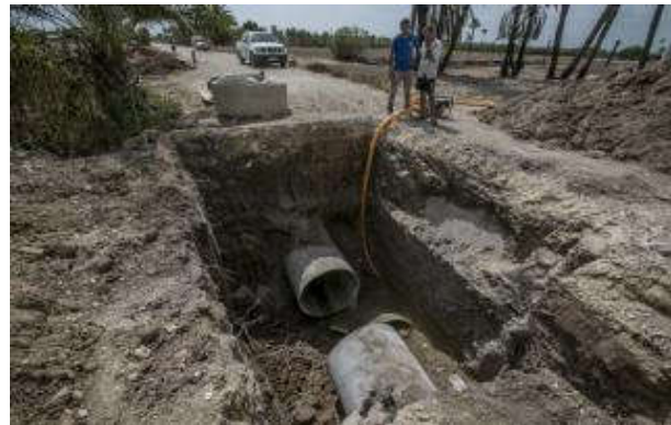
El primer canal averiado, en proceso de reparación, en una imagen de ayer por la mañana. ANTONIO AMORÓS
