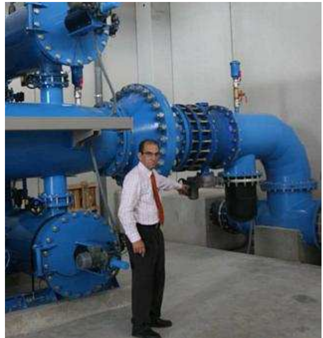
Urbina señala la tubería de conexión entre Riegos de Levante y la SAT DIEGO FOTÓGRAFOS
