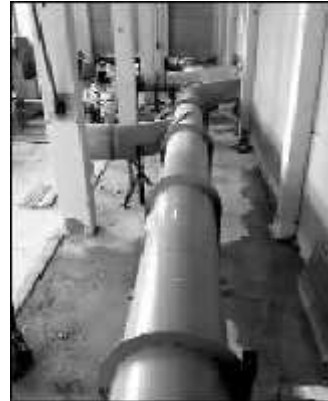
Tubería empleada en un tramo del trasvase Júcar-Vinalopó
