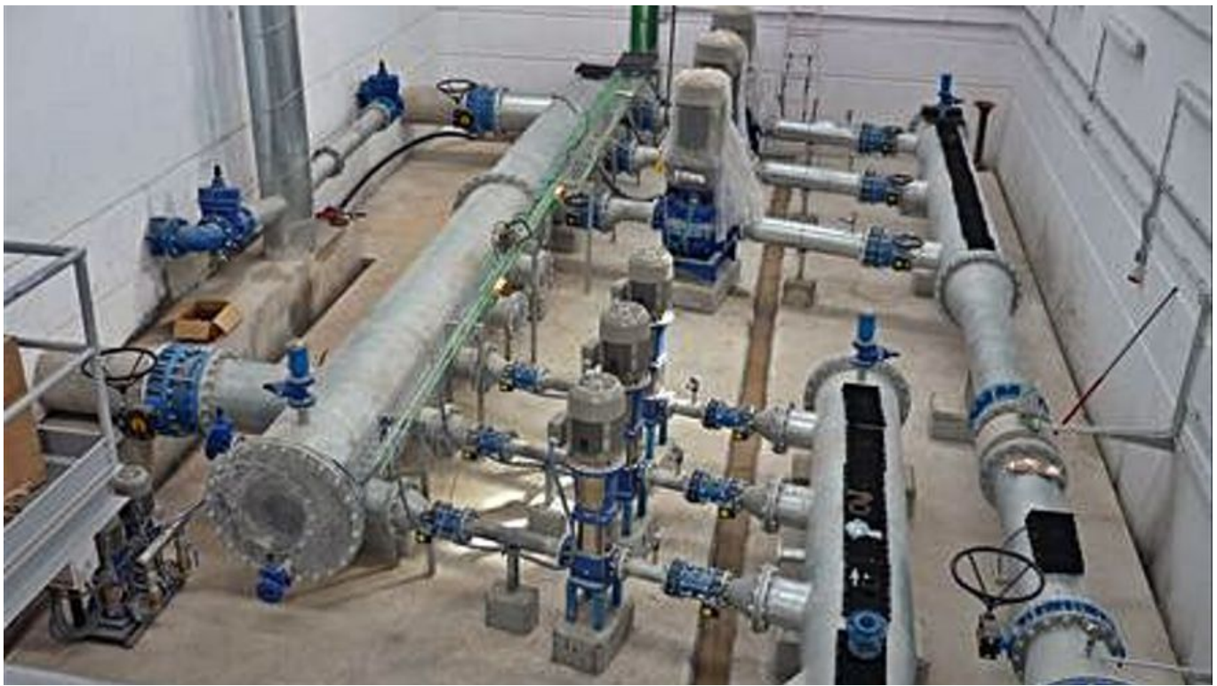
Interior de la desalinizadora. | ACUAMED
