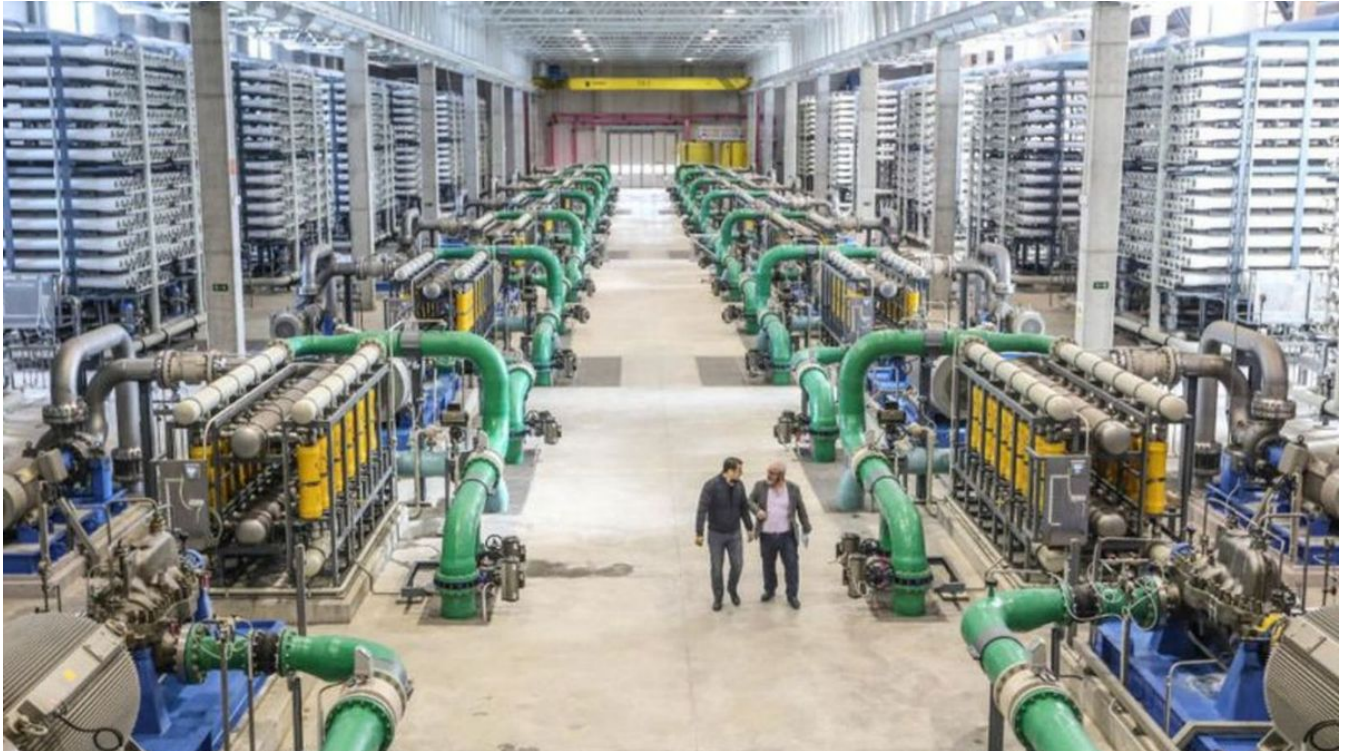
Interior de las instalaciones de Torrevieja. | L.O.
