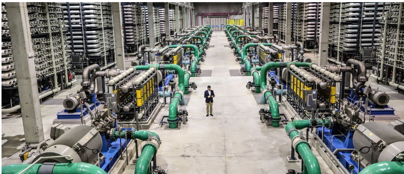
Imagen del interior de la macrodesaladora de Torrevieja. / TONY SEVILLA
