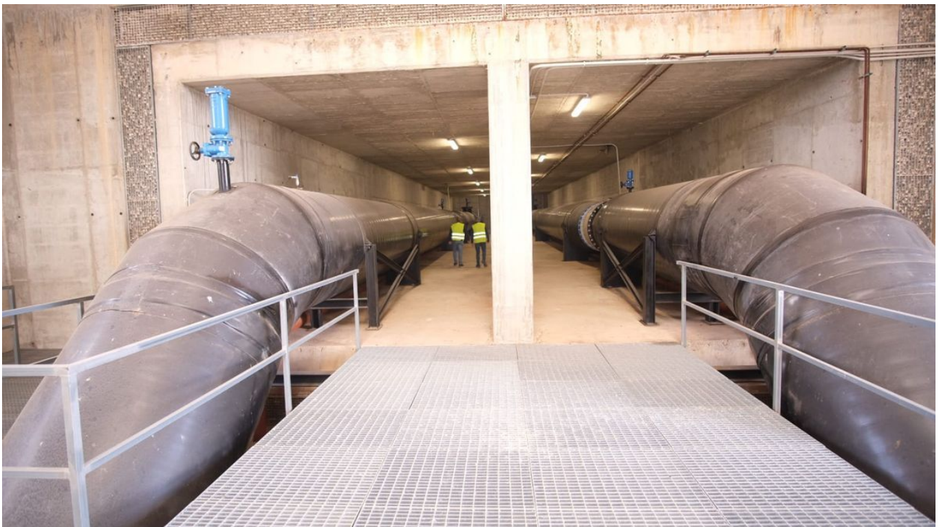
Las conducciones de distribución de los caudales del trasvase del Júcar-Vinalopó en el término municipal de Villena. ÁXEL ÁLVAREZ
