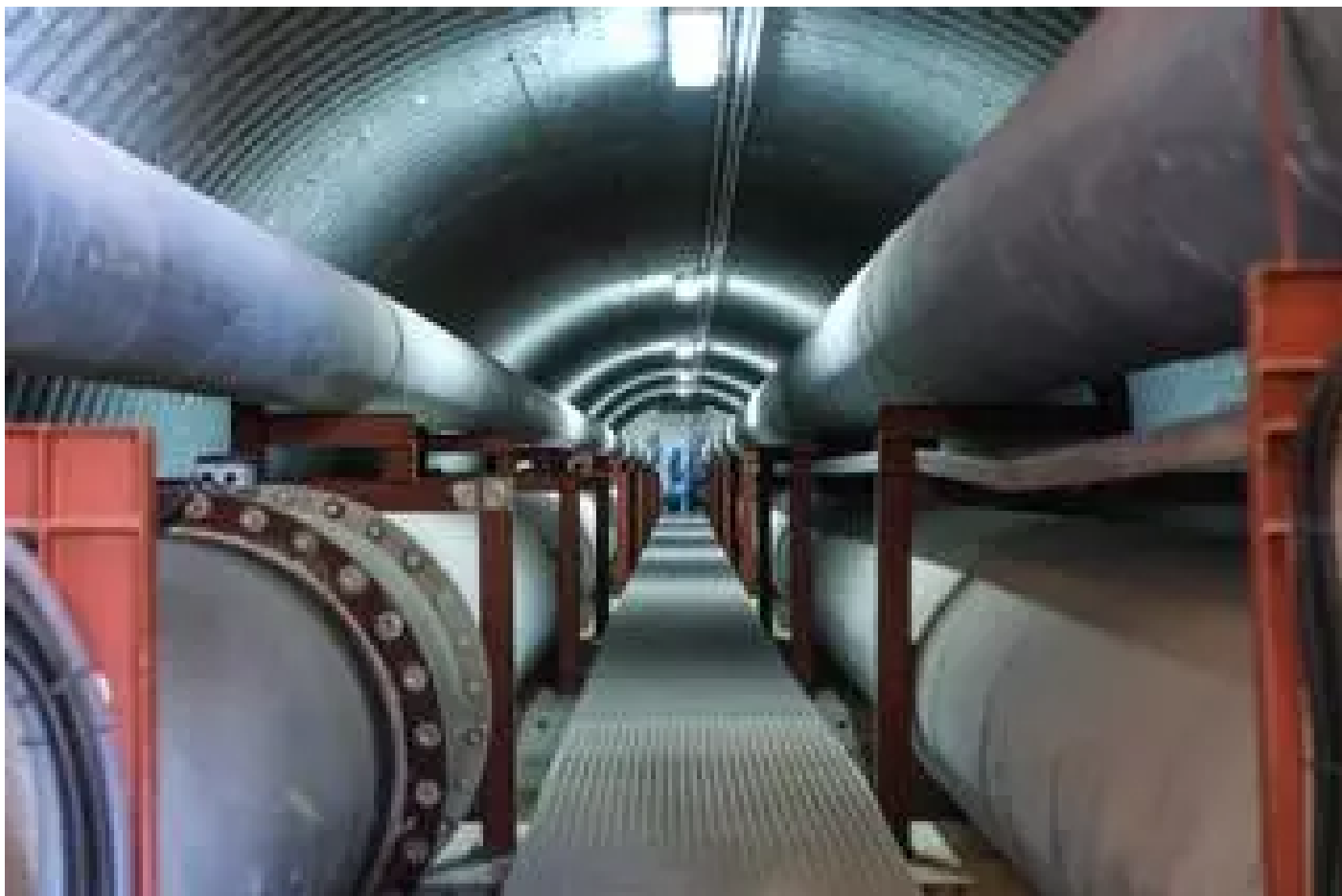
Infraestructuras del trasvase Júcar-Vinalopó en el embalse del Toscar, uno de los reguladores del agua del trasvase del Júcar en los valles del Vinalopó / AXEL ALVAREZ
